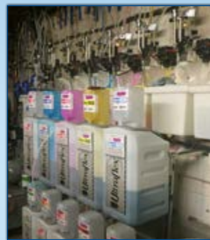
UltraFlex Installation in a SONNY'S mini tunnel.
